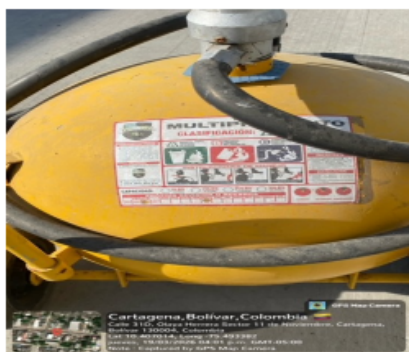
Figura 13. Extintor satelital Vigente
