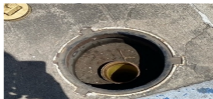
Figura 6. Pozo de monitoreos.
