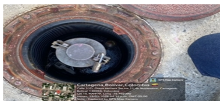
Figura 4. Bocatoma Tanque Subterráneo
