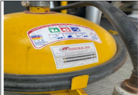
Figura 22. Extintor satelital Vigente
