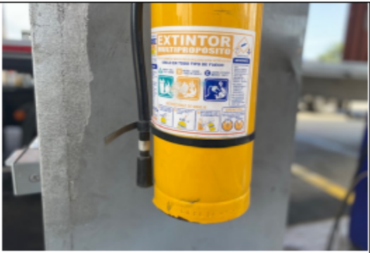
Figura 23. Extintor de las islas Vigente
