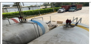
Figura 4. Bombas de los Tanques aéreos
