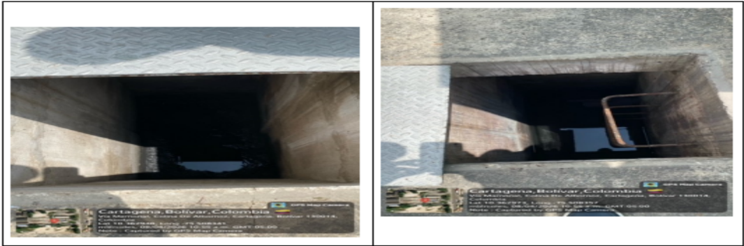
Figura 15. TRAMPA DE GRASA Figura 16. ULTIMA TRAMPA DE GRASA.
