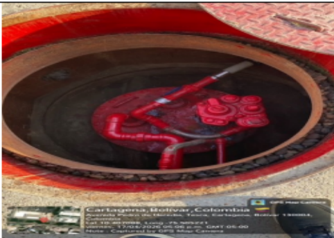
Figura 5. Bocatoma tanque subterraneo.
