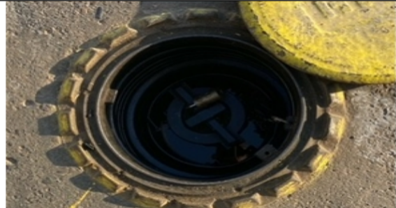
Figura 4. Bocatoma Tanque Subterráneo
