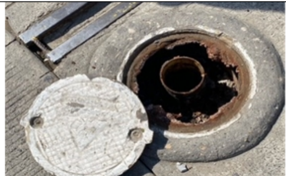
Figura 6. Pozo de monitoreos
