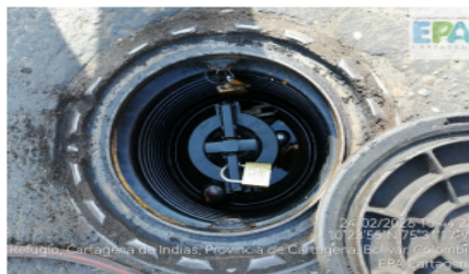
Figura 4. Boca de llenado
