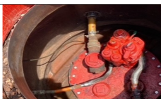
Figura 4. Bocatoma llenado corriente.
