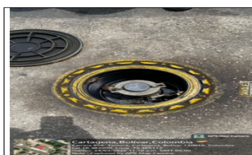
Figura 5. Bocatoma para llenado ACPM
