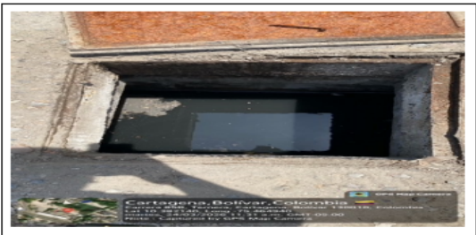
Figura 17. ULTIMA RAMPA DE GRASAS
