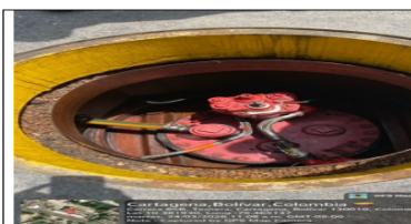
Figura 3. Tanque subterráneo Diesel.
