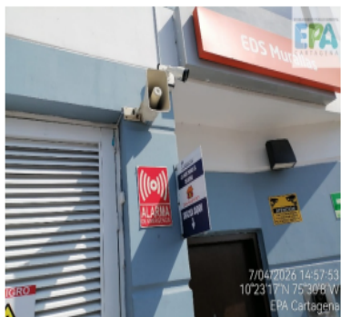
Figura 11. Alarma de emergencia
