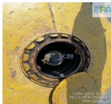
Figura 4. Boca de llenado
