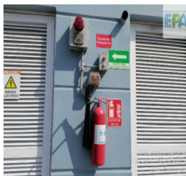
Figura 12. Para de emergencia
