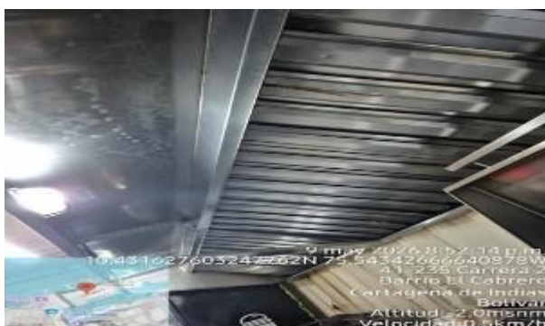
Figura 4: Campana extractora Fuente: Propia
