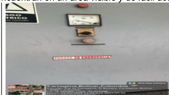
Figura 20. PARADA No 1 DE EMERGENCIA
