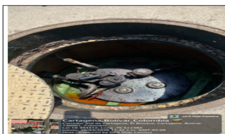
Figura 3. Tanque Subterráneo Diésel.
