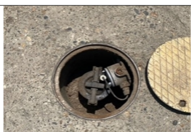
Figura 4. Bocatoma llenada Diésel
