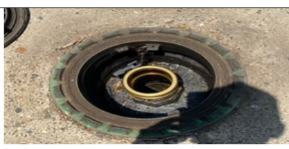
Figura 6. Pozo de Observación
