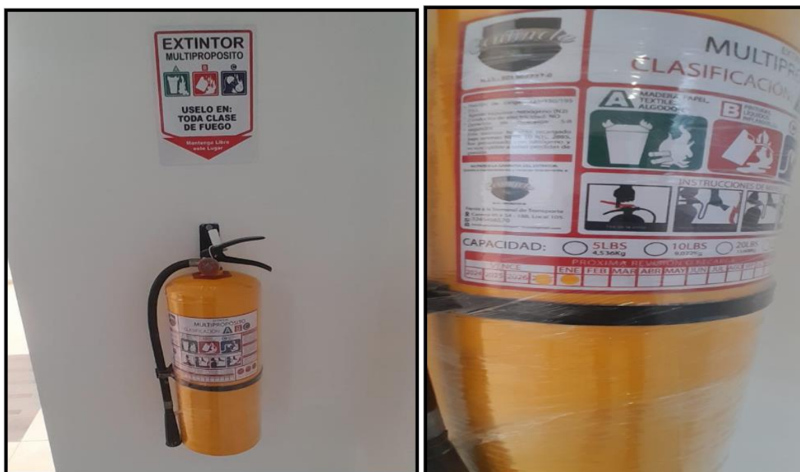
Foto 11 (extintor contra incendio vigente)
