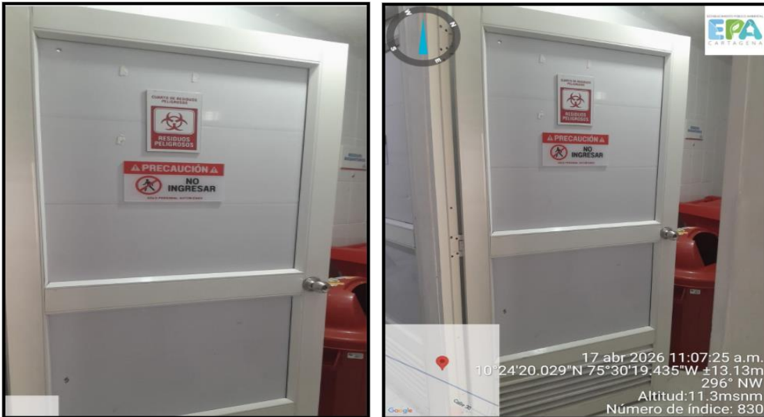
Foto 5. Almacenamiento de RESPEL (Puertas y/o accesos rotulados)
