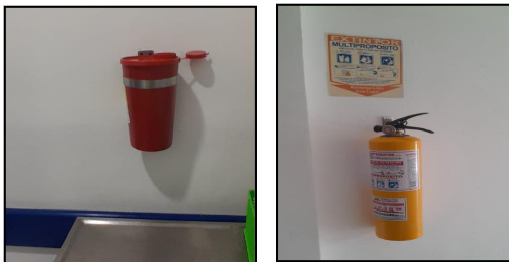
Foto 10 (guardianes de disposición de residuos cortopunzantes, 11 (extintor contra incendio vigente)
