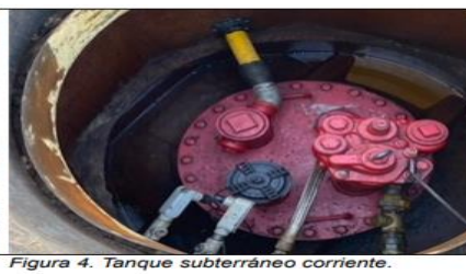
Figura 4. Tanque subterráneo corriente.
