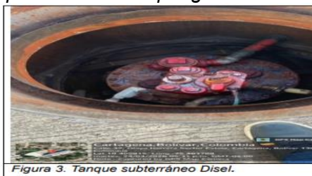
Figura 3. Tanque subterráneo Disel.
