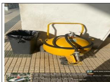
Figura 21. Extintor satelital Vigente
