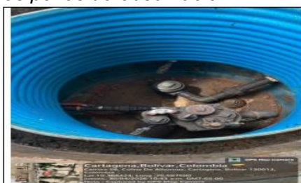
Figura 3. Tanque subterráneo Corriente
