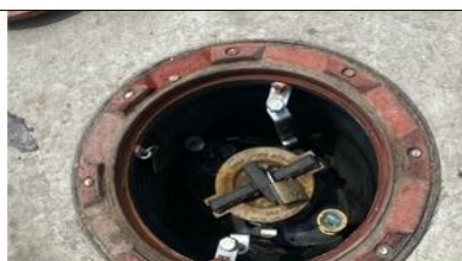
Figura 4. Bocatoma Tanque Subterráneo
