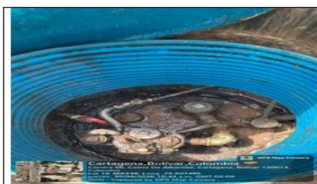
Figura 5. Tanque subterraneo extra
