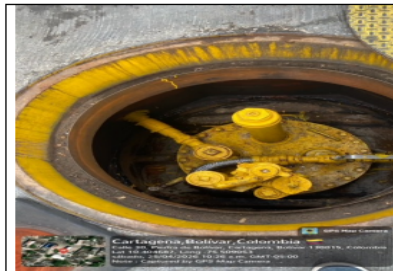
Figura 3. Tanque subterráneo Diesel
