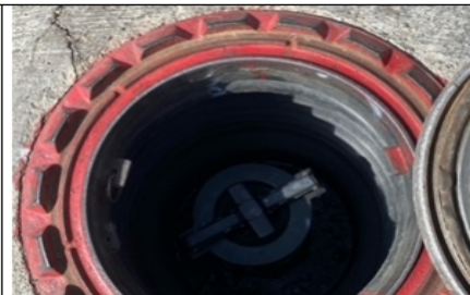
Figura 4. Bocatoma Tanque Subterráneo
