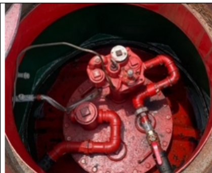
Figura 4. Tanque subterráneo corriente
