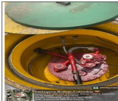
Figura 3. Tanque subterráneo Disel
