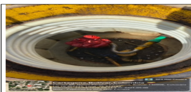
Figura 3. Tanque subterráneo Disel
