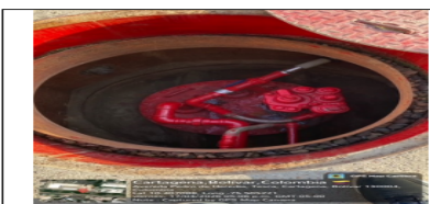
Figura 5. Bocatoma tanque subterráneo.
