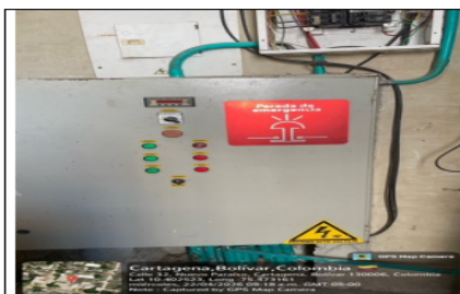
Figura 19. Parada de emergencia.
