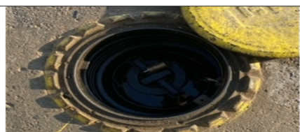
Figura 4. Bocatoma Tanque Subterráneo
