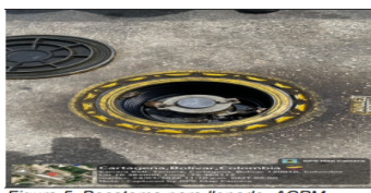
Figura 5. Bocatoma para llenado ACPM
