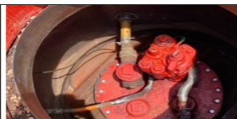
Figura 4. Bocatoma llenado corriente.
