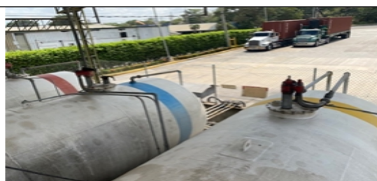
Figura 4. Bombas de los Tanques aéreos
