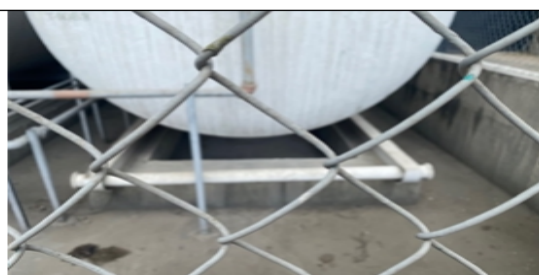
6. Cajas de contencion de los tanques aereos
