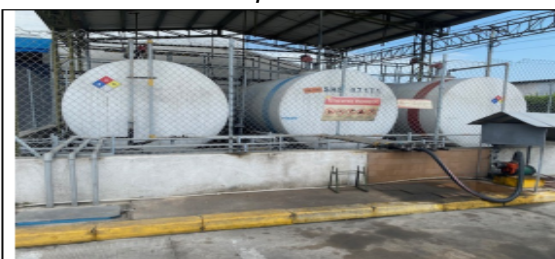
Figura 3. Tanques aéreos o de superficies
