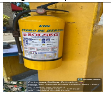
Figura 14. Extintor de las islas vigente
