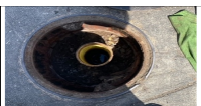
Figura 6. Pozo de observacion
