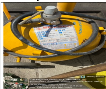
Figura 13. Extintor satelital Vigente
