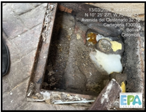
Ilustración 3. Sistema de Tratamiento de Aguas Residuales (Trampa de Grasa)
