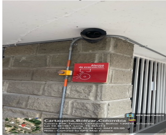
Figura 20. PARADA DE EMERGENCIA
