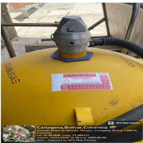
Figura 22. Extintor satelital Vigente
