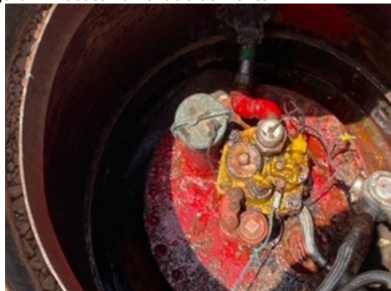
Figura 4. Bocatoma llenado corriente.
