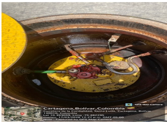
Figura 3. Tanque subterráneo Disel.
