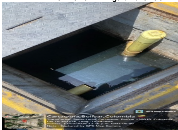
Figura 17. ULTIMA TRAMPA DE GRASAS
