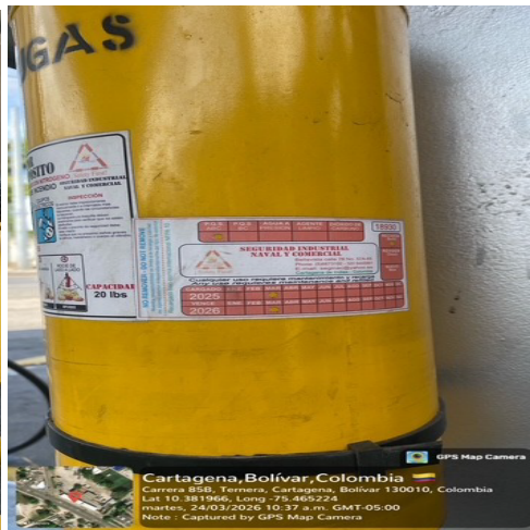
Figura 23. Extintor de las islas vigente
