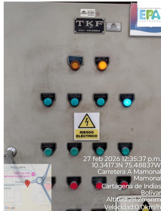
Imagen: Tablero De Encendido-
