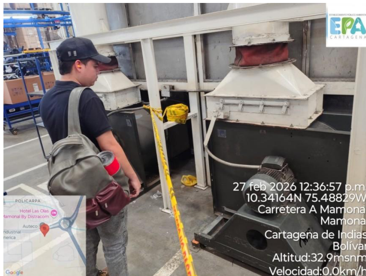
Imagen: Motor De La Cabina Averiado.
