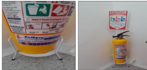
Foto 5. Extintor contra incendios VENCIDO
