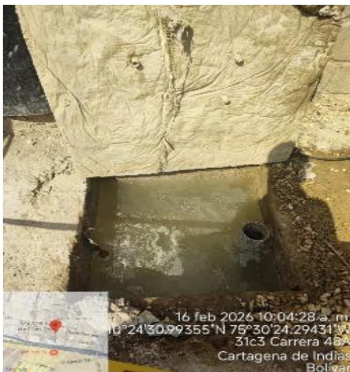
Ilustración 5. Sistema de sedimentación para las Aguas Residuales provenientes del lavado de las canaletas Mixer y llantas de vehículos.
