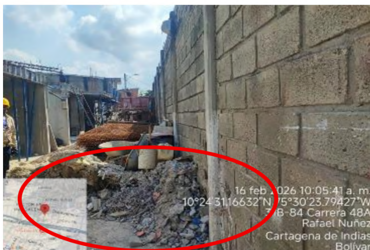
Ilustración 3. Almacenamiento de RCD de tipo pétreo.
