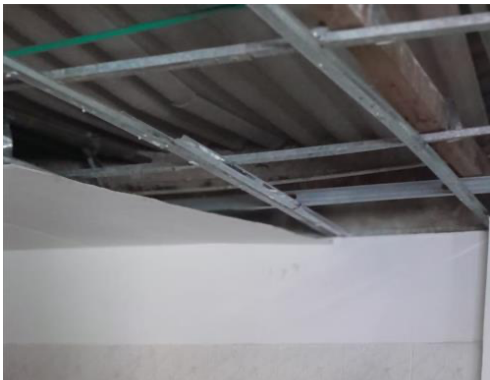
Foto 12 (Techo en condiciones inadecuadas)
