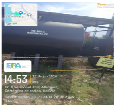
Ilustración 5. Tanques utilizados para las ARD de los buques
