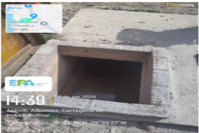
Ilustración 1. Tanque de almacenamiento temporal Porteria
