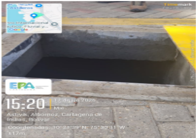
Ilustración 2. Tanque oficinas administrativas
